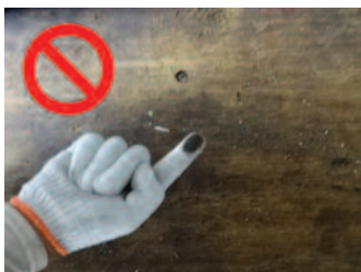
Manchas que se puedan transferir 8
